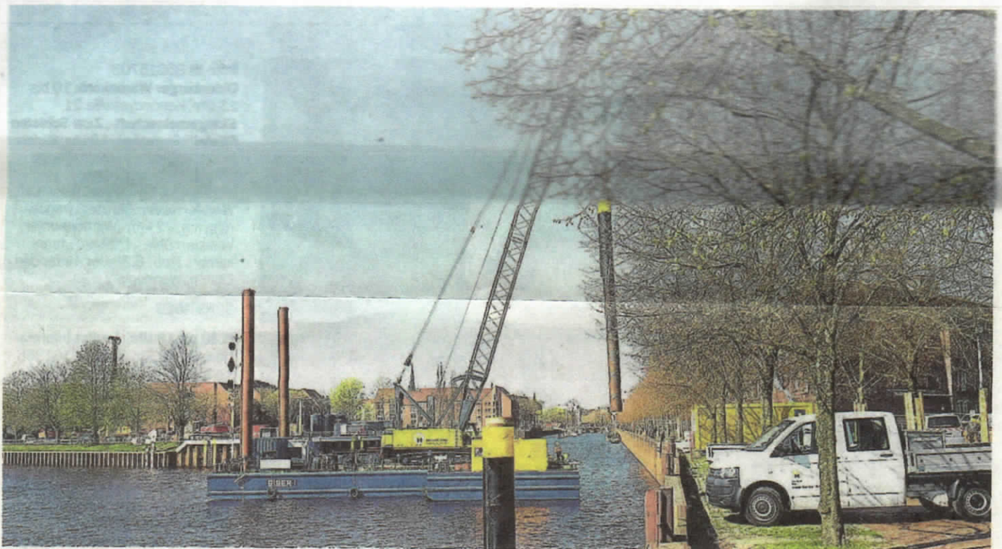
Viel Betrieb: Am Stadthafen wurde gegenüber der Doktorsklappe am Dienstag eine fünf Tonnen schwere und 16 Meter lange Dalbe vom Ufer ins Wasser gehoben.
