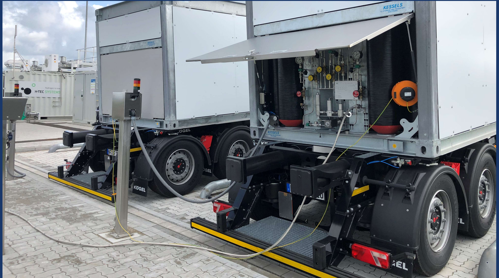
Mobile Wasserstoffspeicher in Bosbüll, Nordfriesland
