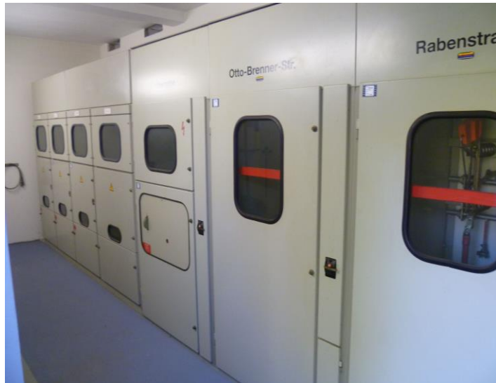
Bestehende, luftisolierte Mittelspannungs-Übergabeschaltanlage
